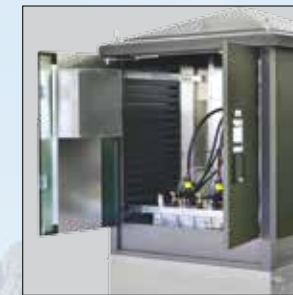
AMS-SKAP Plassert i dør inn mot trafo.
